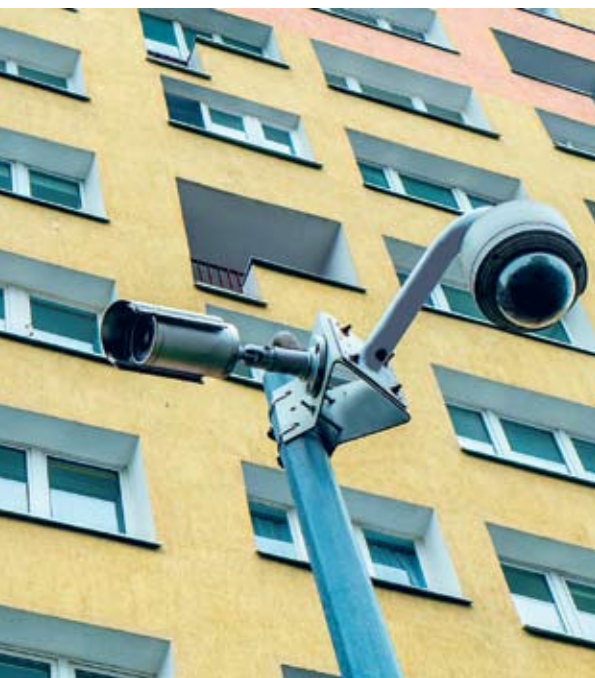
Zewnętrzne kamery na osiedlu „Pojezierze”
